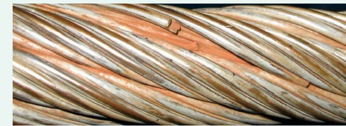
Korrosion in der Litzengasse fällt nicht nur von weitem ins Auge, sondern kann auch zu schwer erkennbaren Drahtbrüchen führen [Quelle: IFT Uni Stuttgart]
