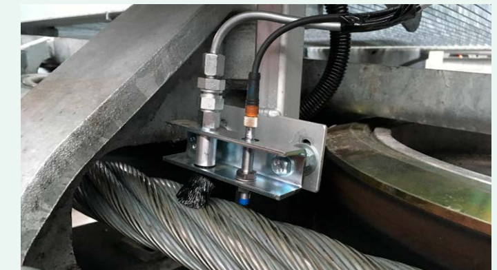
Schmierung mittels Geschwindigkeitssensor und automatischer Dosierung [Quelle: Elaskon / ROTEC GmbH]
