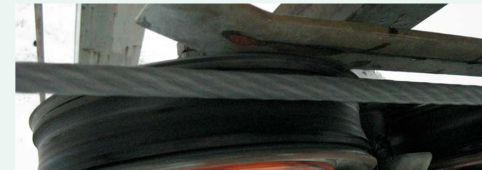
Flach ausgefahrenes Rillenprofil, das Seil bzw. die Klemmen haben schon das Leitblech berührt
