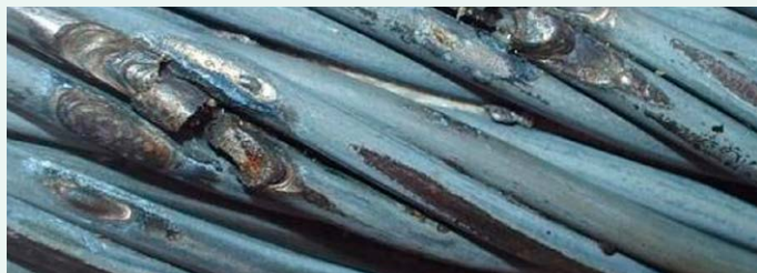
Blitzschlag – die Oberflächenverfärbungen neben den Drahtbrüchen lassen sich unter Umständen noch retten [Quelle: IFT Uni Stuttgart]
