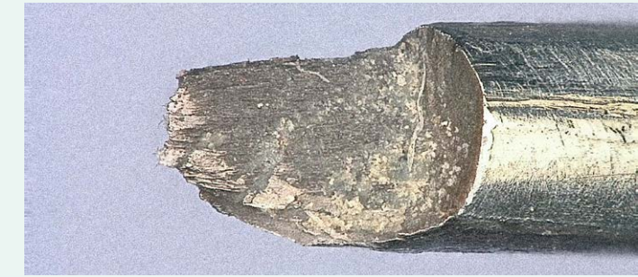
Detail eines Ermüdungsbruchs mit ebener Bruchfläche im Seilbahnseil
